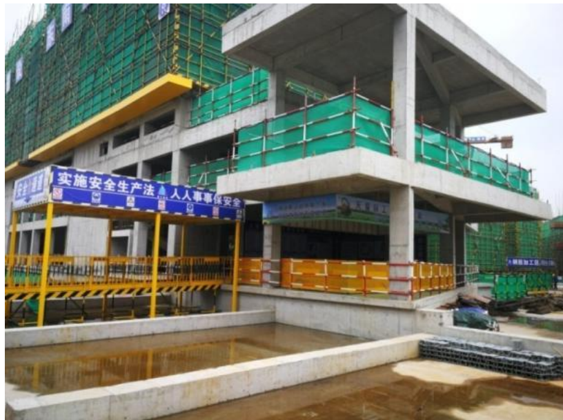
楼层临边防护
