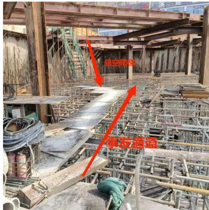
事故现场照片
