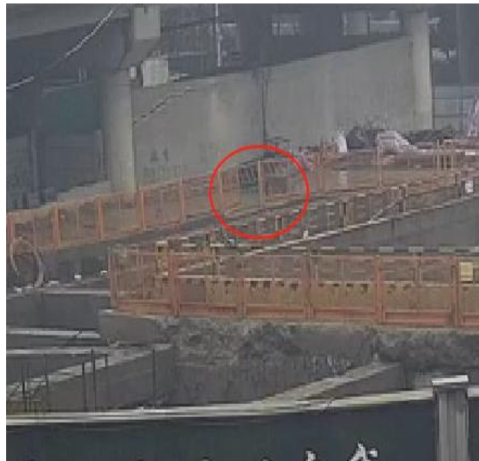
事故现场照片
