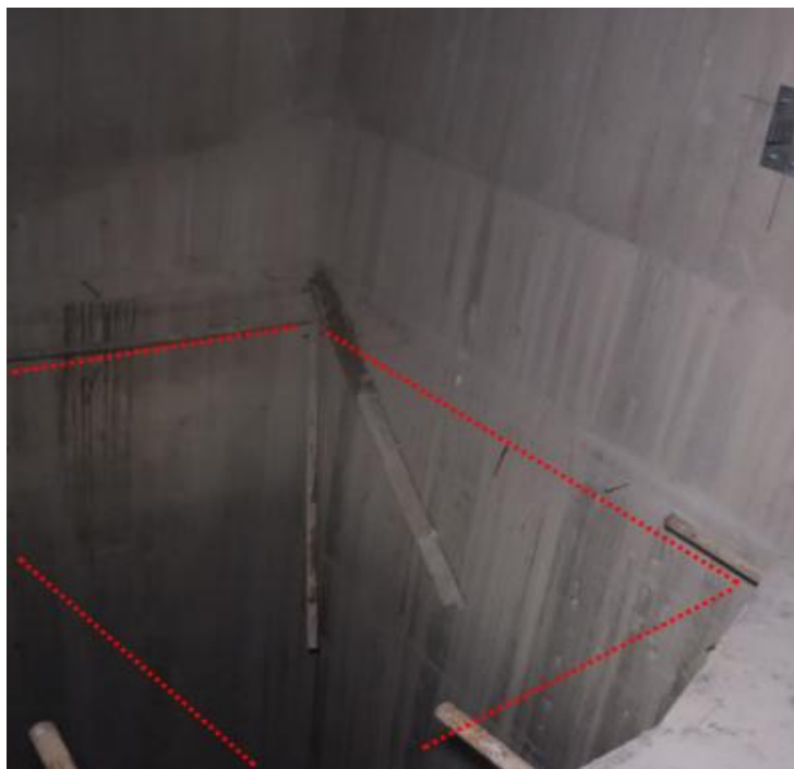
事故现场照片
